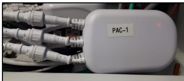
Image 2 : Capteur AEOTEC (mesure de la puissance électrique consommée par la PAC)
