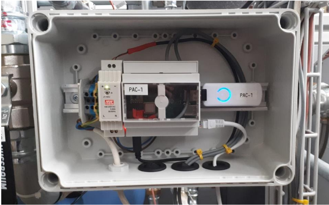
Image 8 : Coffret de protection pour le matériel électrique
