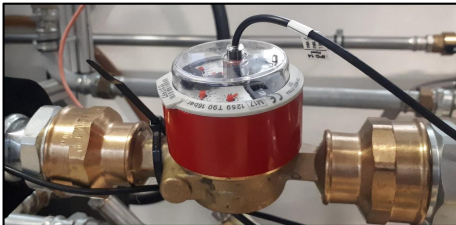
Image 1 : Débitmètre à impulsions
