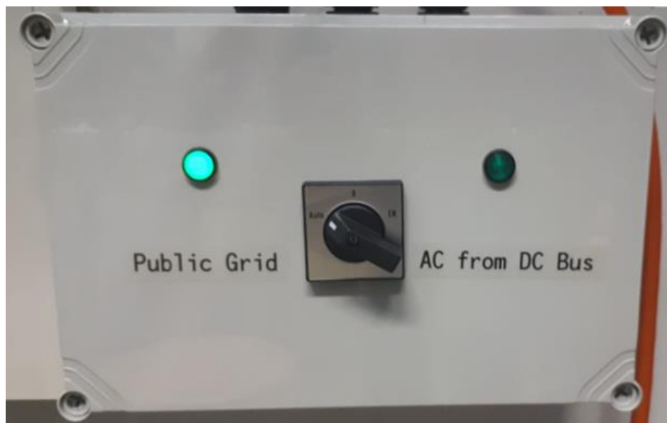
Annexe 2 : Boîtier d'alimentation de la pompe à chaleur du laboratoire thermique de la HEI de Sion
